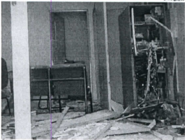
Caixa eletrônico e o interior da agência do Bradesco ficaram destruídos
