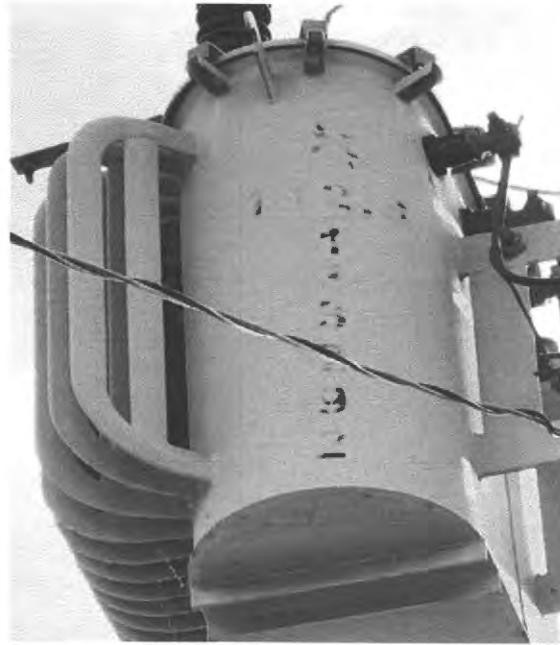
Figura 7. Transformador da Escola Municipal Joana Menezes
