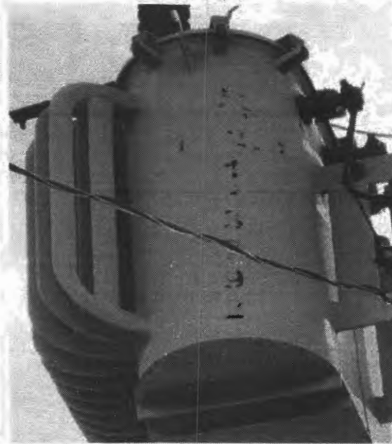
Figura 7. Transformador da Escola Municipal Joana Menezes
