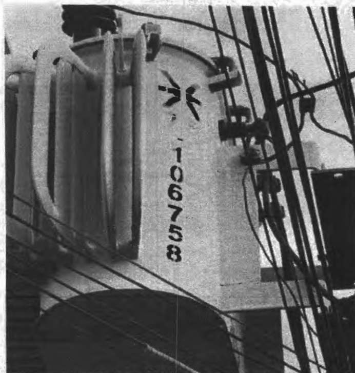
Figura 9. Transformador da Escola Municipal Nicolau Dino
