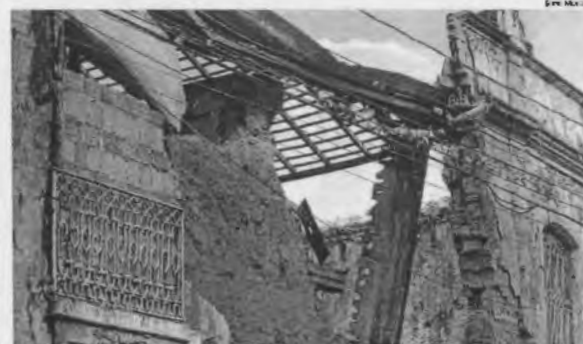
Casarão que desabou parcialmente permanece sem obras e pode causar acidentes, se continuar a chover
