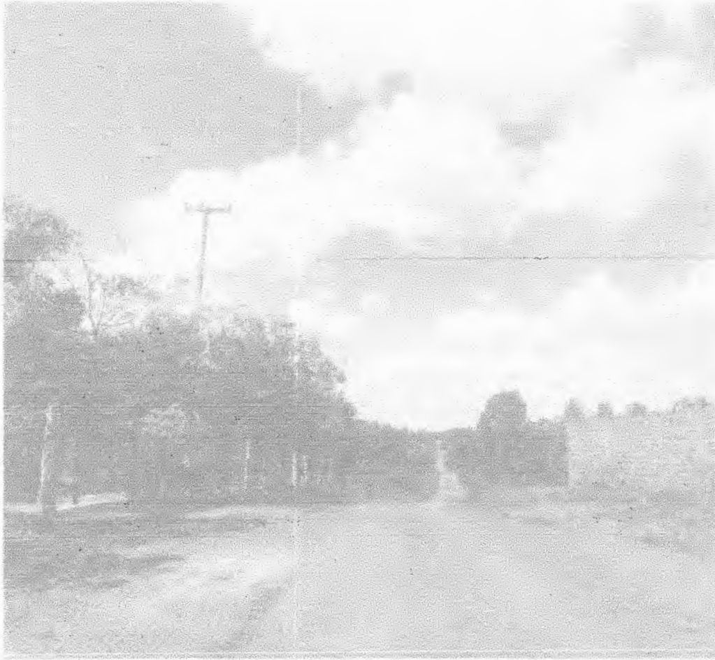
Trecho executado ligado entre a MA-034 e ao povoado gatu zona rural de Passagem Franca-Ma
