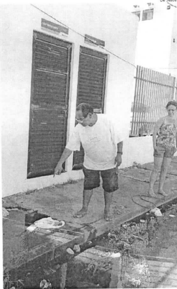
Morador da Rua 3, na Cohab, mostra rede de esgoto estourada
