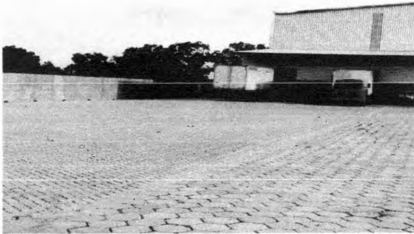
Imagem 06: Área do pátio externo de pavimentação de concreto em bloco sextavado de 25x25cm, espessura 8cm, sobre coxim de areia.
