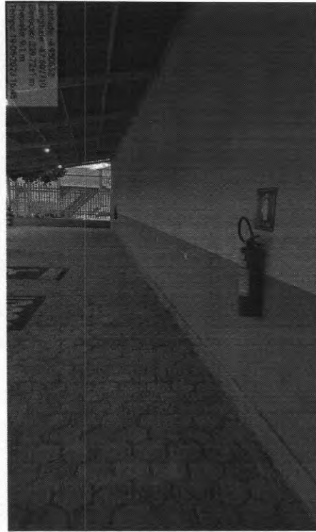
IMAGEM 12: LOCAÇÃO DE EXTINTORES.
