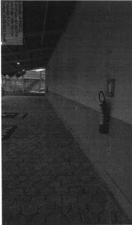
IMAGEM 11: LOCAÇÃO DE EXTINTORES.
